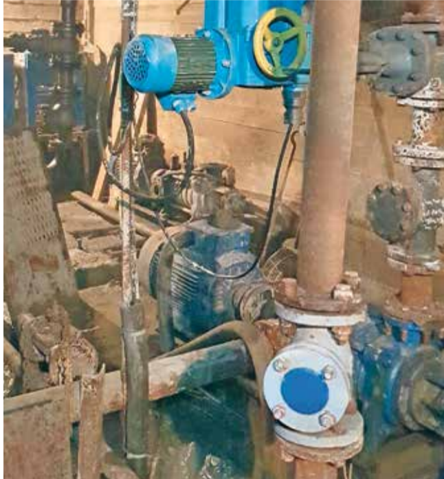
Оборудование зумпфовой насосной
