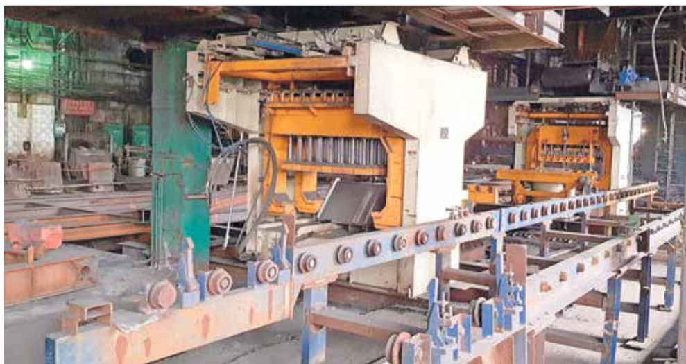
Новое оборудование полностью смонтировано
