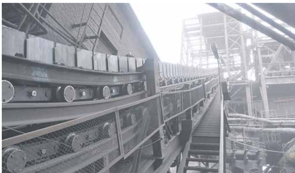
Конвейер запущен в эксплуатацию
