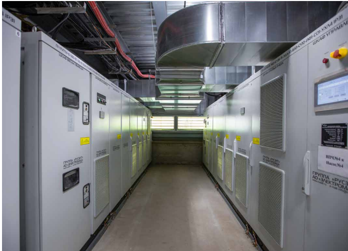
Высоковольтные преобразователи частоты объекта «Временный гидротранспорт хвостов обогащения».
