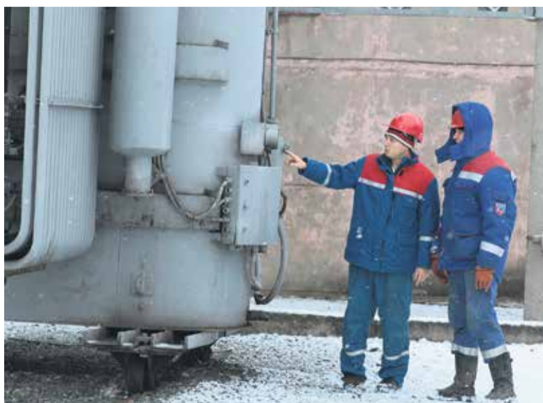
Сергей Сорокин и Евгений Минаев снимают показания температуры силового трансформатора
